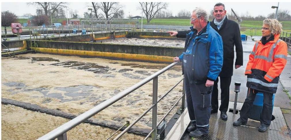
Klärwerksleiterin Simone Meiert, Betriebsleiter Christoph Born und Reinhard Baumann werfen einen Blick auf das Belebungsbecken im Klärwerk, das saniert wird.
